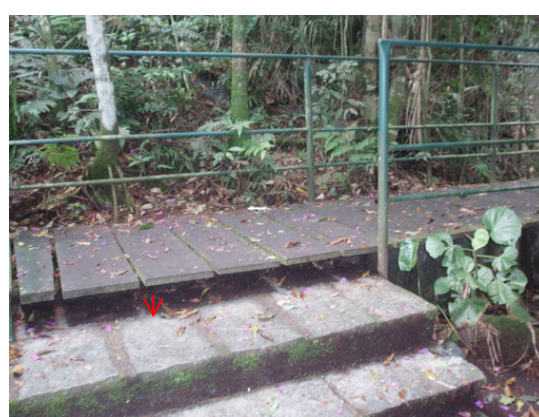
Figura 19 - Degrau no fim da trilha suspensa.
